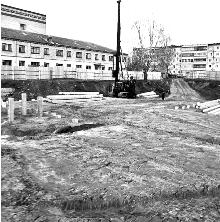
• Октябрь 2018 года. На пустыре возле детского и инфекционного отделений областной больницы № 12 в Заводоуковске развернулось строительство здания стоматологии.
